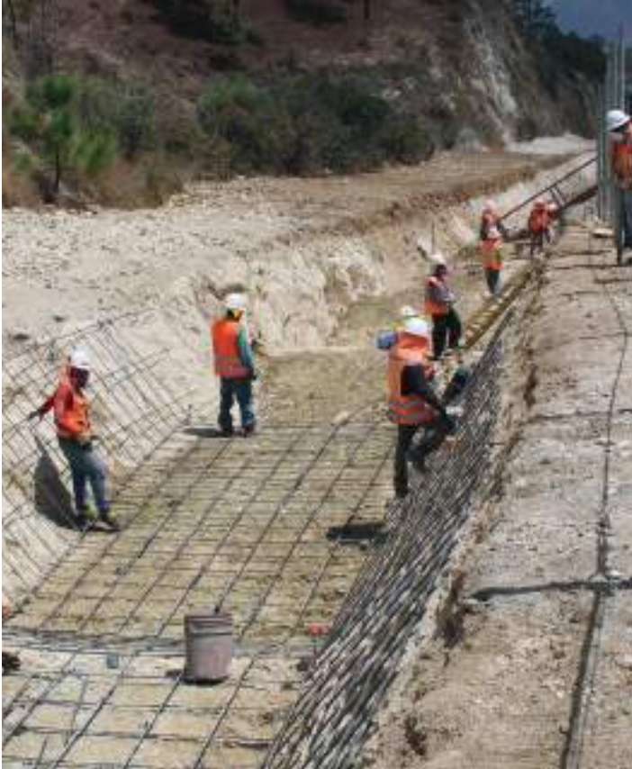
En el inicio del área de la Pista de Aterrizaje, los operarios trabajan en la construcción del canal.
