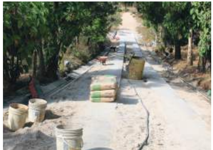
Imagen de una parte de la carrilera cuando todavía estaba en proceso de construcción.
