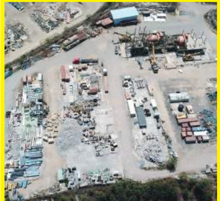
De lo que fue la Planta de Procesos Producción ya solo están en pie los molinos. Lo demás, ya fue desmontado.
