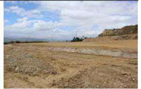
En el Patio de Trituración, como se llamó en la etapa productiva, habrá un canal para controlar la precipitación pluvial.
