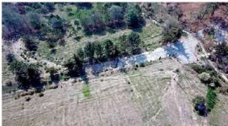
La Planta de Lácteos ya fue desmantelada y se espera el pronto inicio de la recuperación ambiental.
