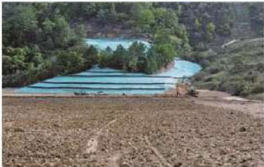
El talud que sella el portal de la mina subterránea fue revegetado y cubierto con geotextil.
