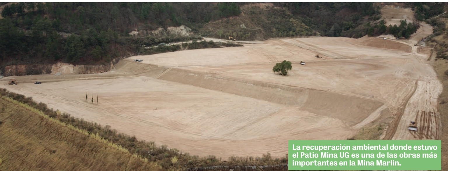
Operarios dan últimos toques a sitios donde se fundirán canales para desfogar agua de lluvia, en área adyacente a La Escombrera.
