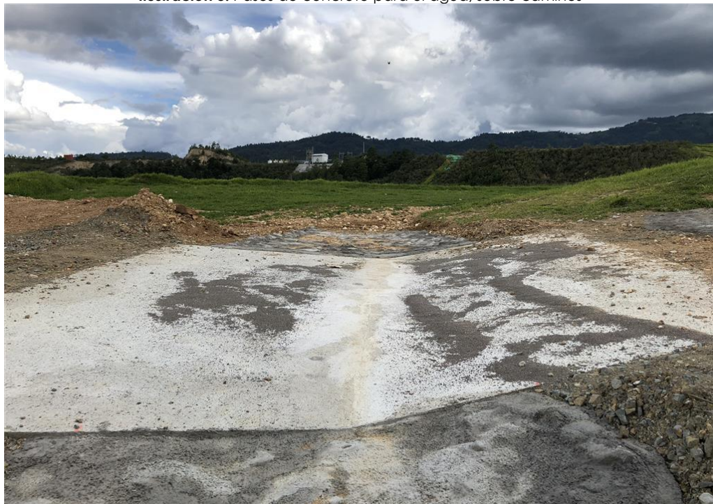
Ilustración 3. Pasos de concreto para el agua, sobre caminos
