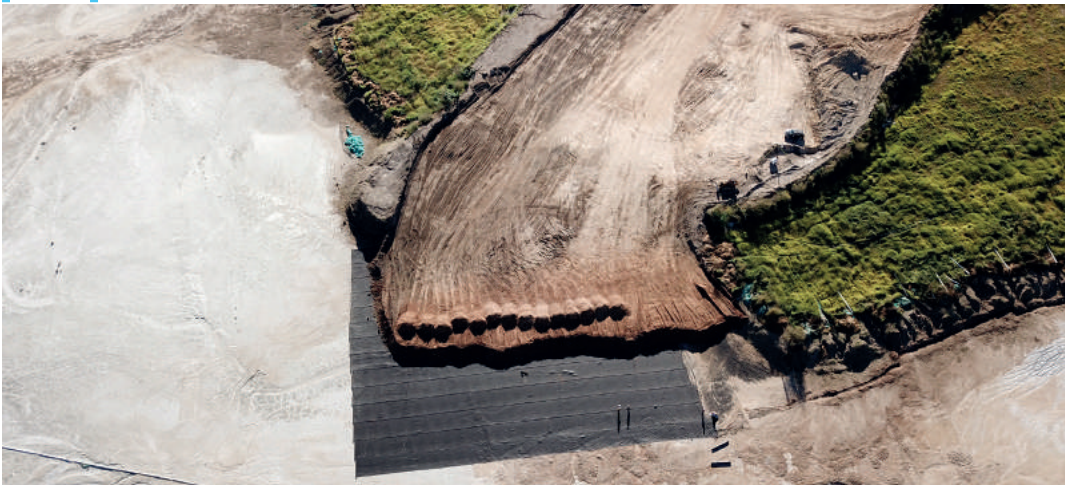
Imagen aérea de otro frente de trabajo donde también se muestra cómo marcha la cobertura.
