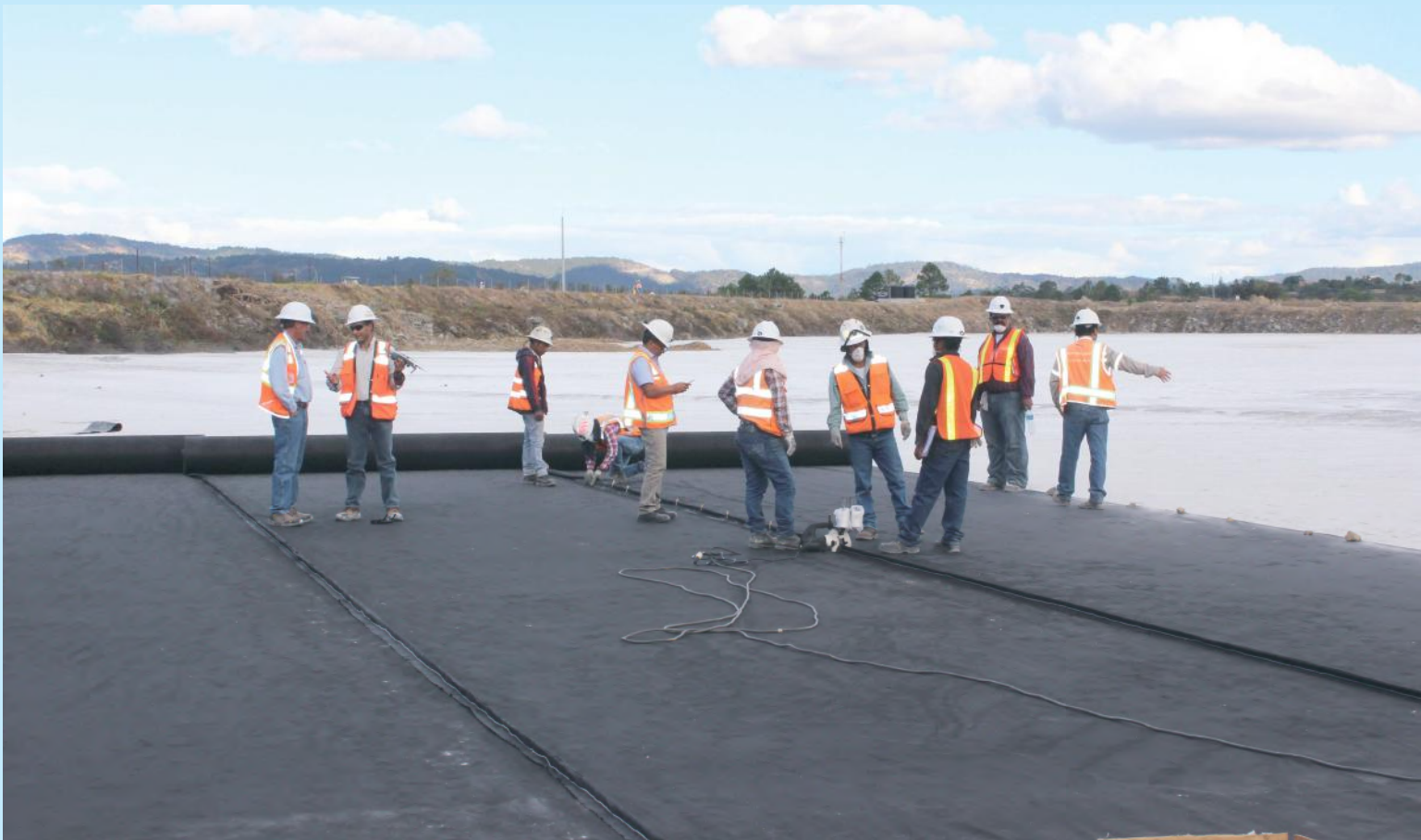
Trabajadores colocando el geotextil antes del relleno para asegurar la consolidación de los suelos.
