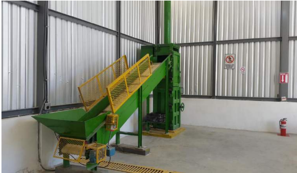
Ilustración 3. Compactadora y banda de alimentación de residuos
