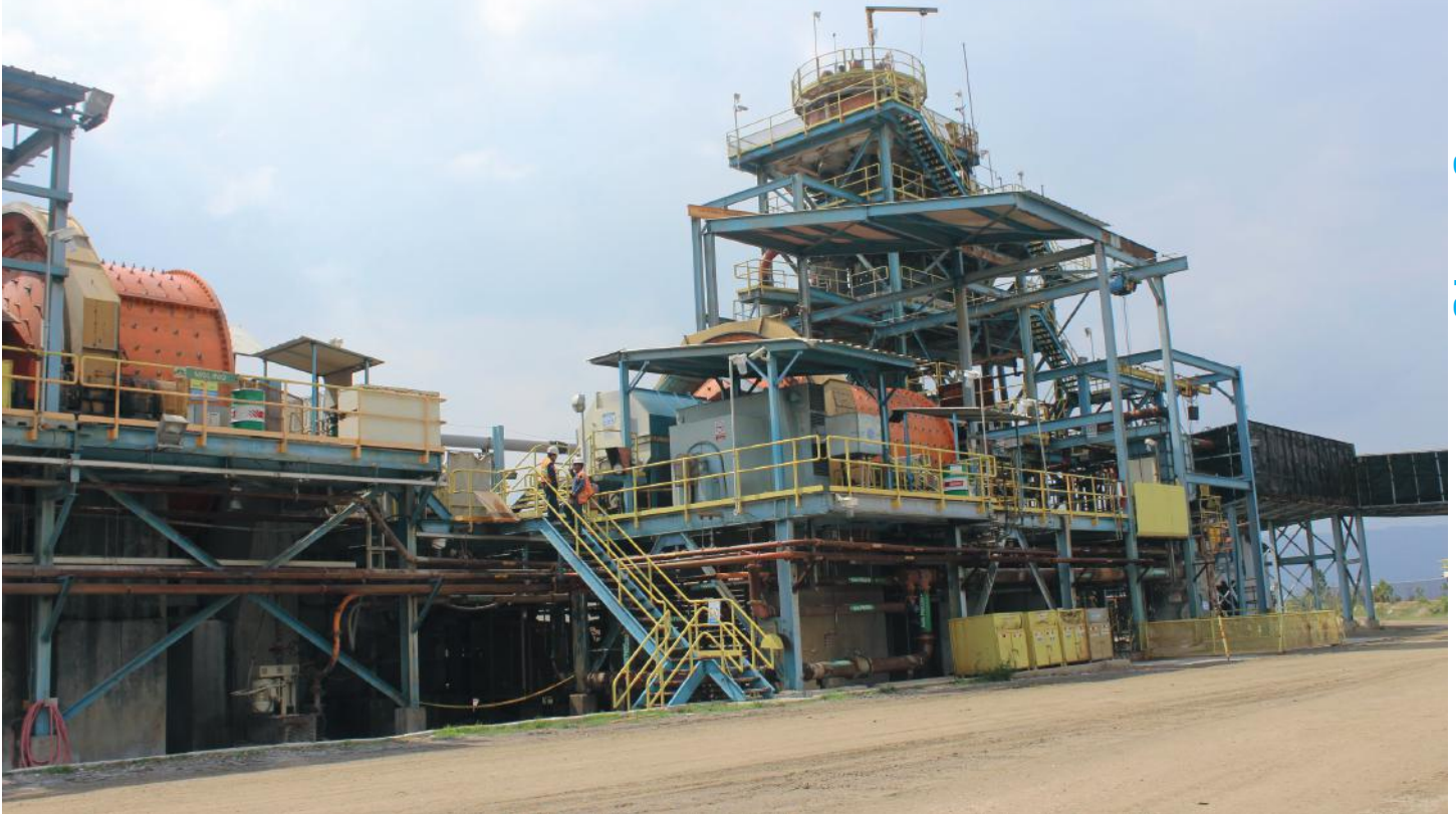
Tras concluir la producción de oro y plata, se inició la limpieza de la Planta de Procesos.
