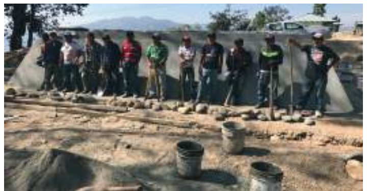
En la aldea Ágel se construyó el tanque de captación de agua más grande de todos los proyectos de agua CIDH.
