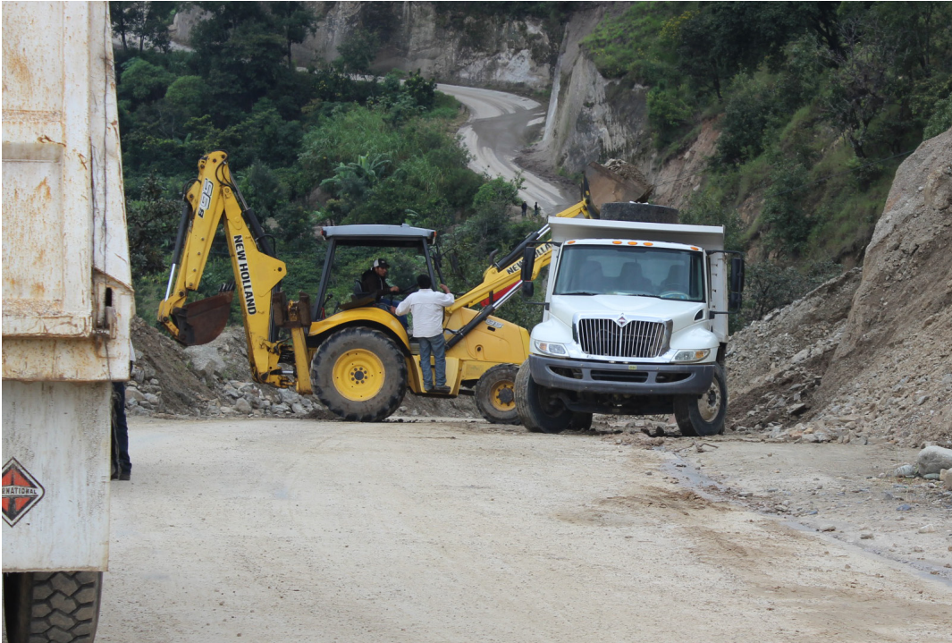
Reparación y limpieza de carretera, financiada por Montana Exploradora, entre San Miguel Ixtahuacán, San Marcos, y San Gaspar Ixil, Huehuetenango.
