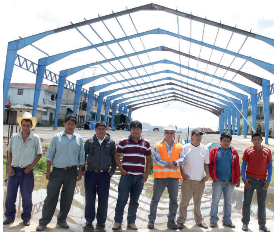
Autoridades comunitarias, junto al ingeniero Fernando Gómez (chaleco naranja), frente a la estructura que soportará el techo.
