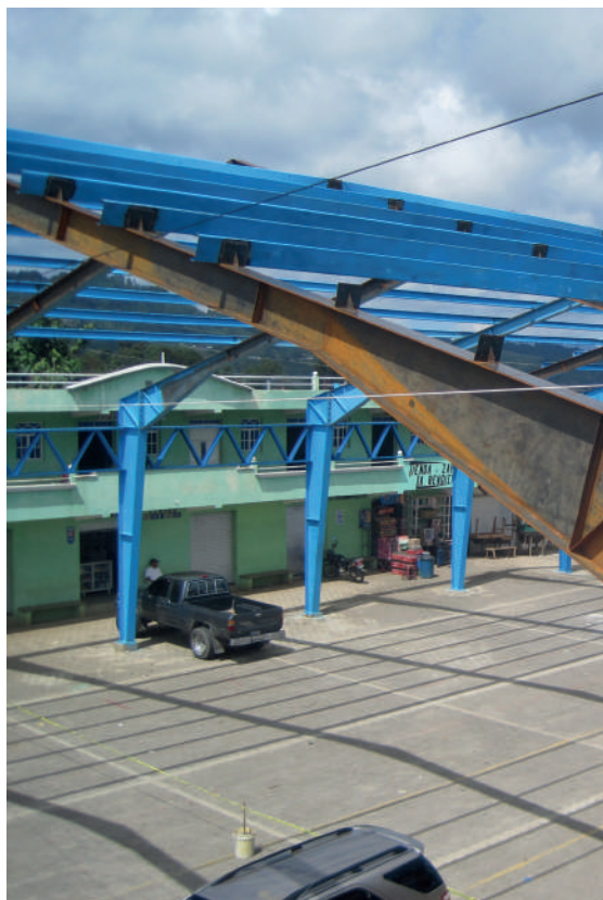
La estructura instalada es de la más alta calidad en materiales de construcción.
