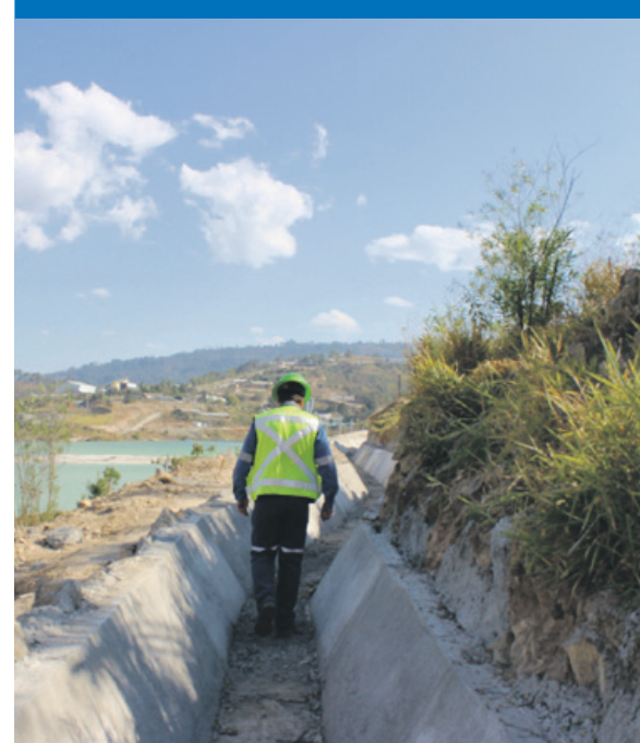
Canal de coronación de la Mina Marlin
