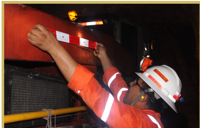
La UDE no solo se encarga de la formación de operadores, sino, además, hace trabajos de señalización en la mina.
